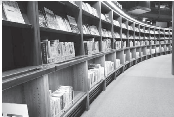
書架下部に設けたスリット状の吹出口
